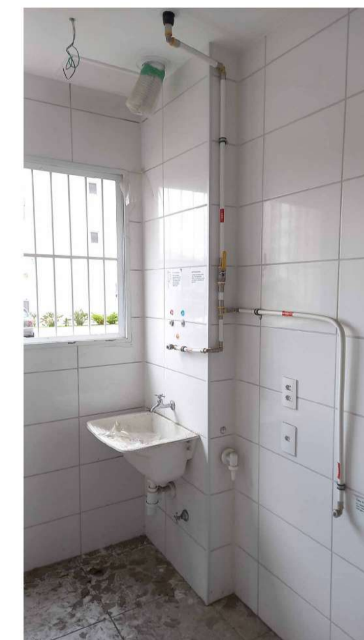
FOTO DA INSTALAÇÃO ATUAL
